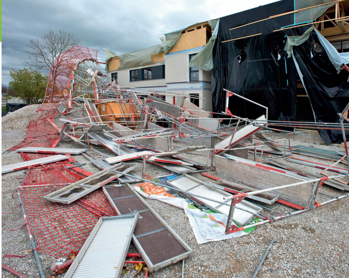
Sturmschaden in Weilheim
