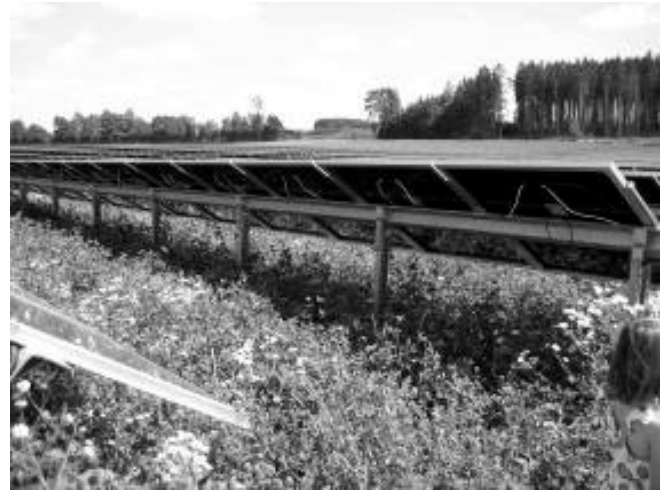
Die Fotovoltaikanlage in Egenhofen-Waltenhofen
